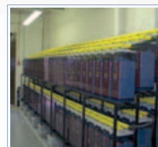
Рис. 24 Смонтированная батарея Classic OGi
