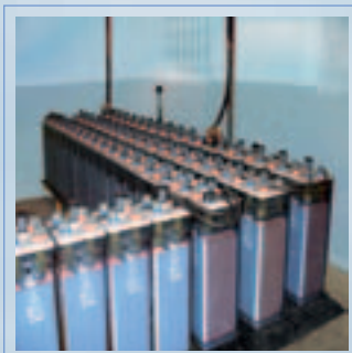
Рис.20 Смонтированная батарея Classic OPzS
