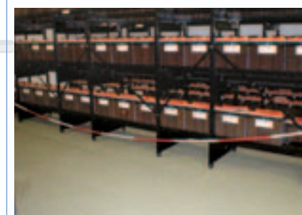
Рис. 23 Смонтированные батареи Classic Energy Bloc
