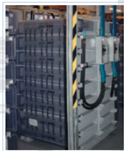
Рис. 9 Аккумуляторы Absolyte – установка в системе бесперебойного питания
